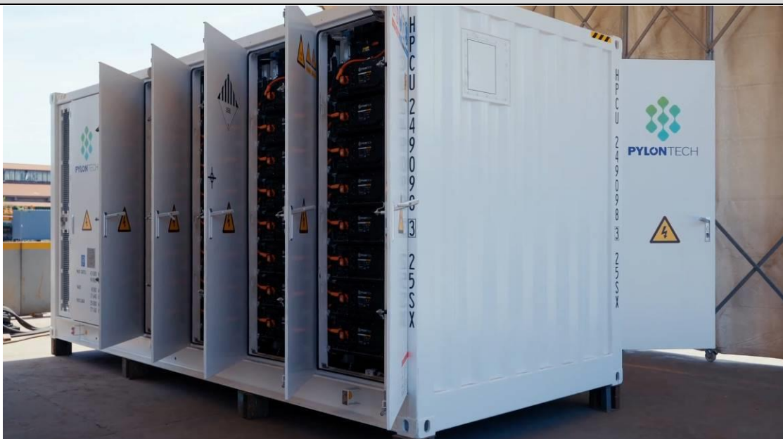
内部 (PowerCube-20H-M7A200C5.015-EU-05 电池系统) Interior (PowerCube-20H-M7A200C5.015-EU-05 battery system)
