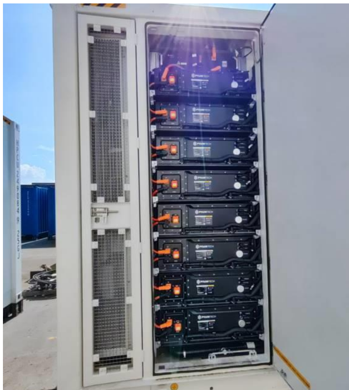
内部 (PowerCube-20H-M7A200C5.015-EU-05 电池系统) Interior (PowerCube-20H-M7A200C5.015-EU-05 battery system)
